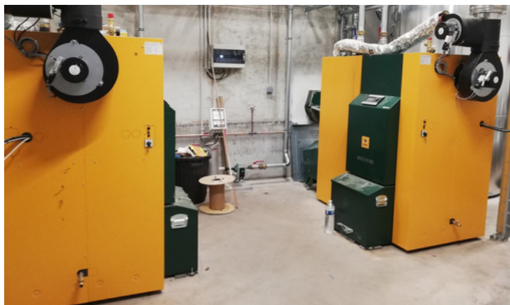
Chaudières bois alimentant le réseau de chaleur de Anzat-le-Luguët (63)
